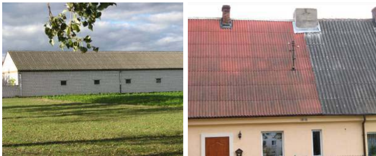
Fot. 12. Nieszkodzone płyty azbestowo-cementowe na budynkach w Śnieciskach i Zaniemyślu – III stopień pilności.
