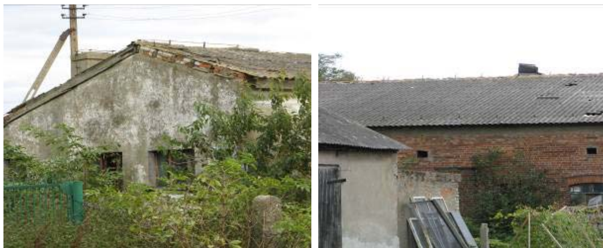
Fot. 10. Uszkodzone płyty azbestowo-cementowe na budynkach w Jaszkowie – I stopień pilności.
