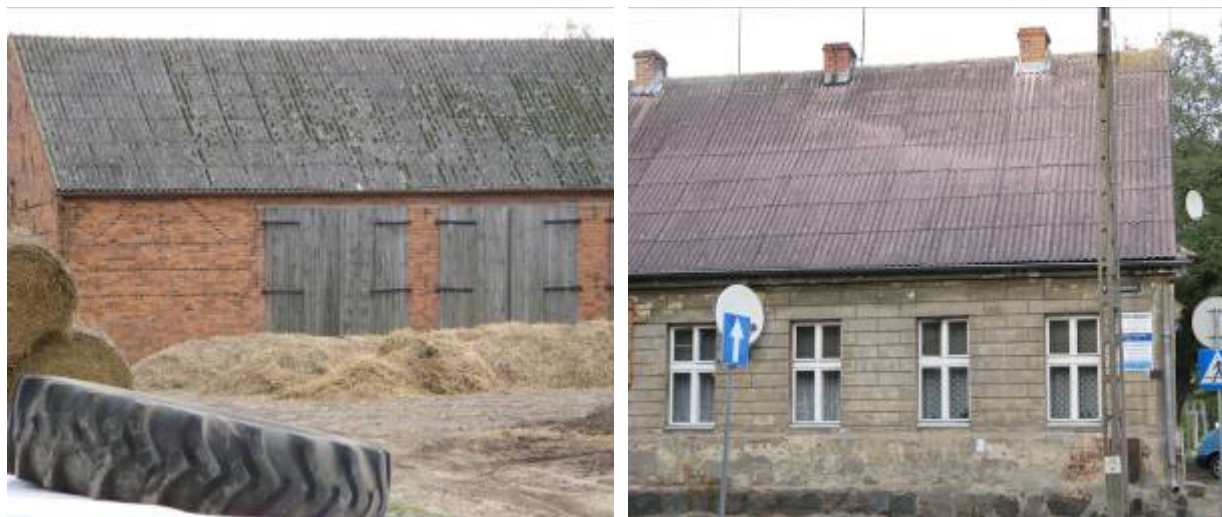
Fot. 11. Płyty azbestowo-cementowe na budynkach w Śnieciskach i Zaniemyślu – II stopień pilności.
